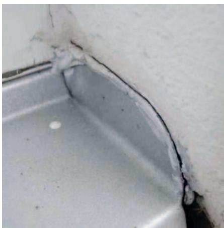
Figur 1: Vatten tränger in genom springor i anslutningen mellan plåtbeslag och vägg vid underkant dörr.
