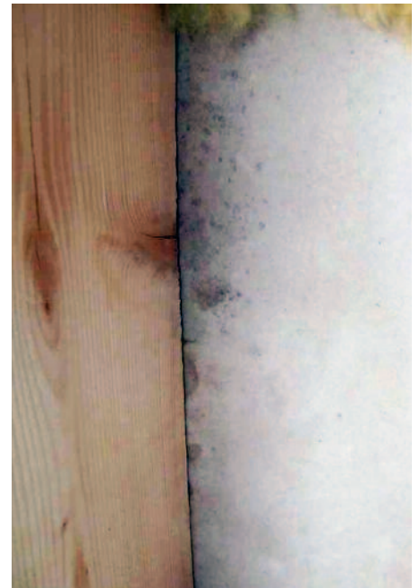
Figur 4: Vy från insidan genom inspektionslucka i yttervägg. Insidan utegips har fukt- och mögelangrepp liksom kraftigt förhöjda halter mikroorganismer och mikrobiella skador.
