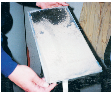
Figur 3: Stora mängder finkornigt cementpulverliknande damm på finfiltret i återluftskanalen.
