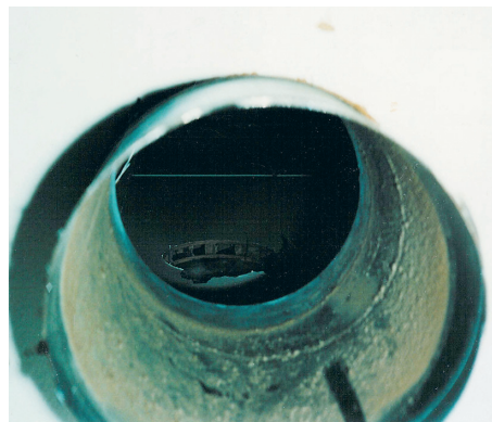
Figur 6: Invändiga föroreningar i tilluftskanal.
