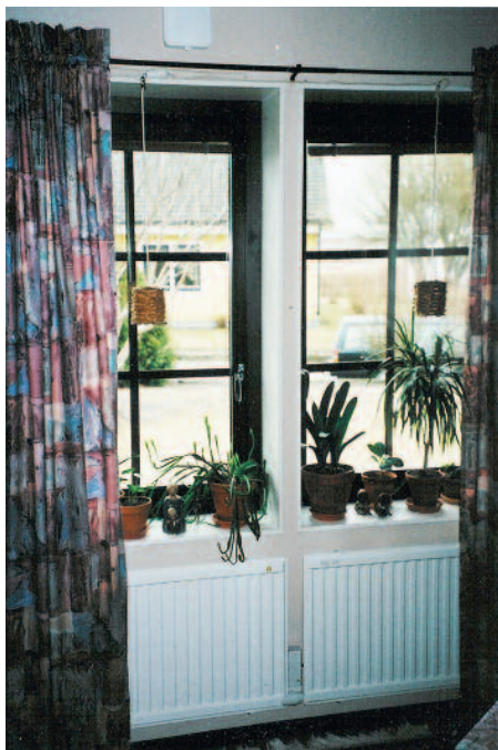
Figur 3: Ombyggnad av luftvärmesystem till frånluftsventilation och oljefyllda elradiatorer. Uteluftsdonens luftspredande egenskaper är viktiga för komforten.
