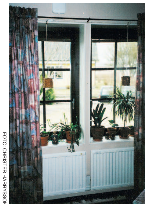
Figur 7: Uteluftsdonets luftspredande egenskaper är viktiga för komforten.
