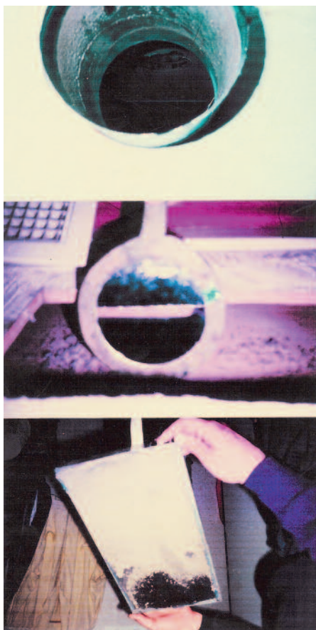
Figur 3: Föroreningar i luftvärmesystem. Bilden överst visar tilluftskanal av plåt, mittenbilden återluftskanal av träfiberskiva och bilden nederst filter i luftvärmeaggregat.
