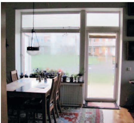
Figur 10: Kondens på utsida energieffektivt fönster i Ellös, augusti 2011.
