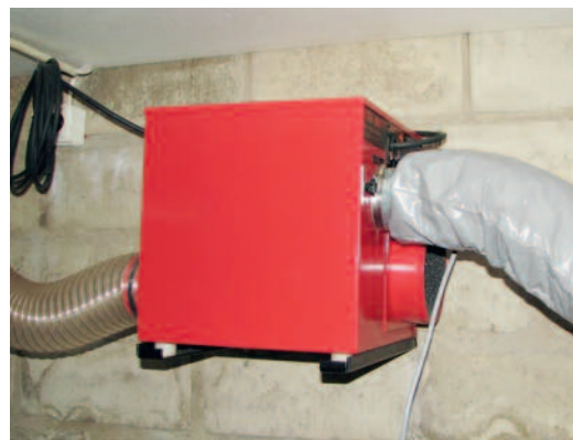
Figur 5: Installation med avfuktare i krypgrund.
