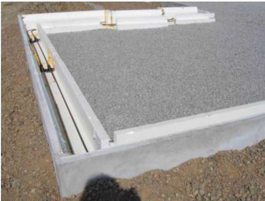
Figur 9. Exempel på platta-på-mark med god kantisolering och små köldbryggor. Foto: Torbjörn Klittervall.
